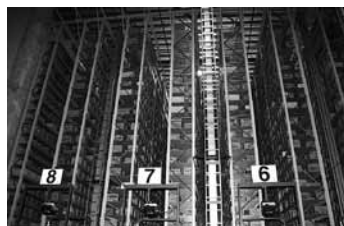
収容能力4万のケース自動倉庫
